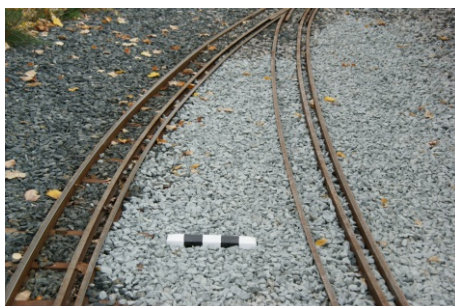
Nově instalovaný námezník
